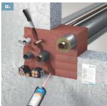
a. Protivpožarna pjena – FPF iz Knauf sistema u masivnom zidu
